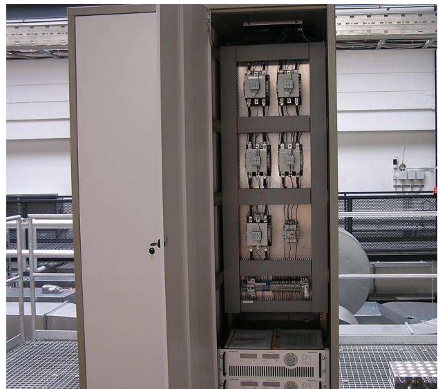
Fig. 3: Steuerschrank für Dipolsteuerung.
