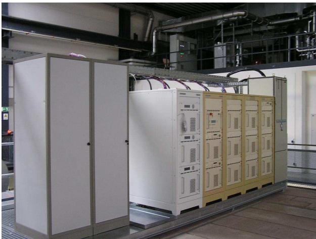
Fig. 1: Neue Installation der DANFYSIK Netzgeräte.
