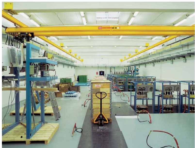
Abb. 3: Blick in die Kondensatorbankhalle
